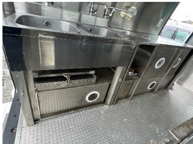
■ 上水道&シンク (上水タンク200ℓ・排水タンク200ℓ)
